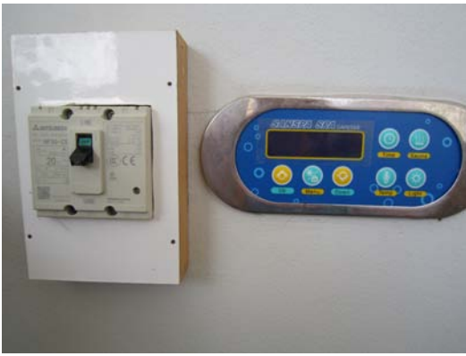
Pääkytkin ja ohjauspaneeli
